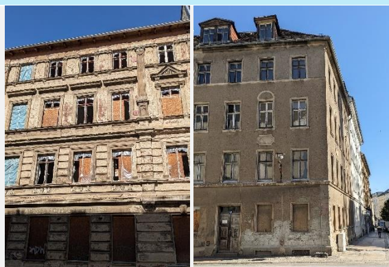
Sanierungsbedarf Salomonstraße/Leipziger Straße
