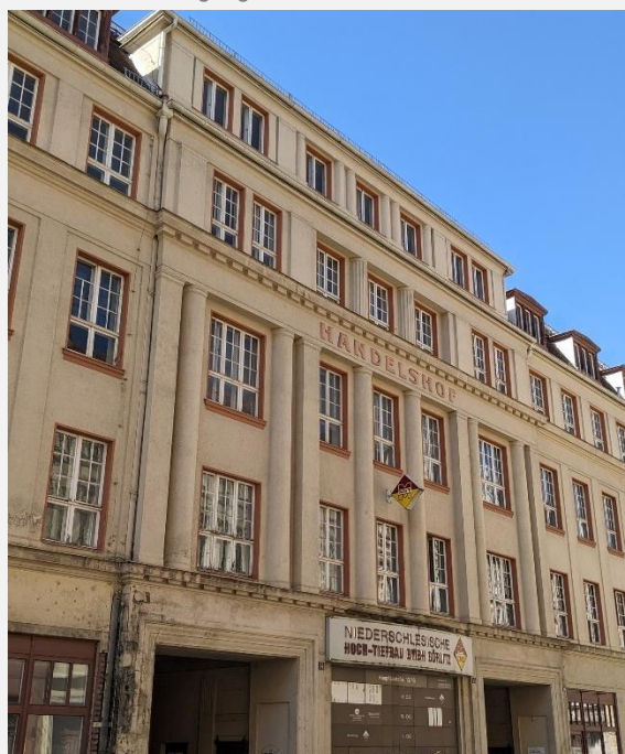
Sanierungsbedarf Handelshof Hospitalstraße
